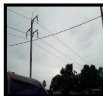
Ligne de haute tension
